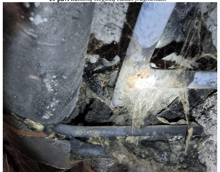
12 pav. Vandentiekio sistemos būklės fragmentas.
