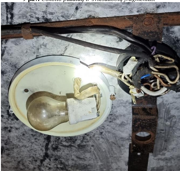
11 pav. Rūšio el. instaliacijos būklės fragmentas.
