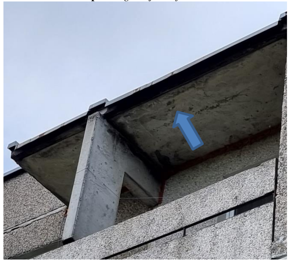
10 pav. Balkonų stoginių būklės fragmentas.
